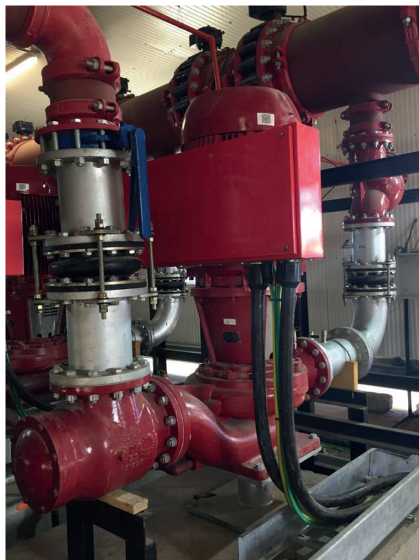
Installation série e-80SCXL dans un centre de données à Dubaï.
