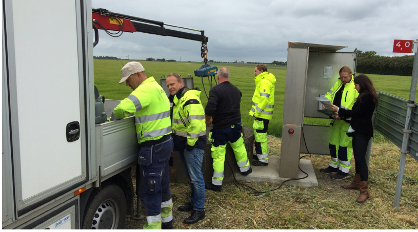
Flygt Concertorin asennus Lomman kunnassa.
