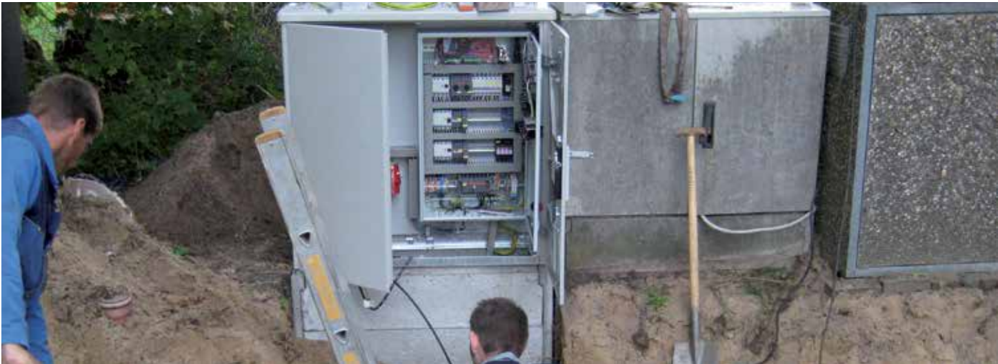
Flygt Commander im Außenschaltschrank installiert
