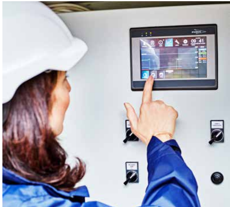
Flygt My Connect® in Stahlblechinnenschrank installiert
