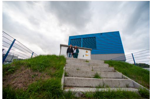
Elektrische installaties staan veilig op een hoger gelegen deel van het terrein
