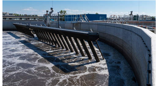
De zuiveringstank met de ICEAS-installatie
