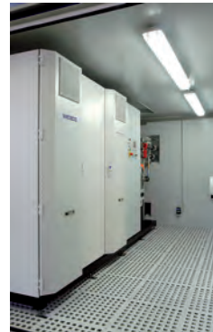
Ozonanlage in einem Container Typ SMO
