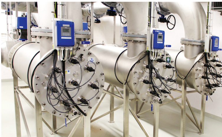
Installierte UV-Anlage mit Wedeco Spektron.
