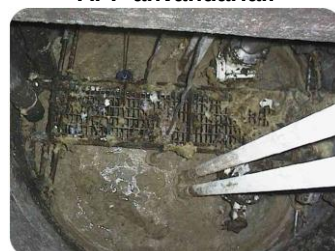
Före installation: Fett och slam har ansamlats.
