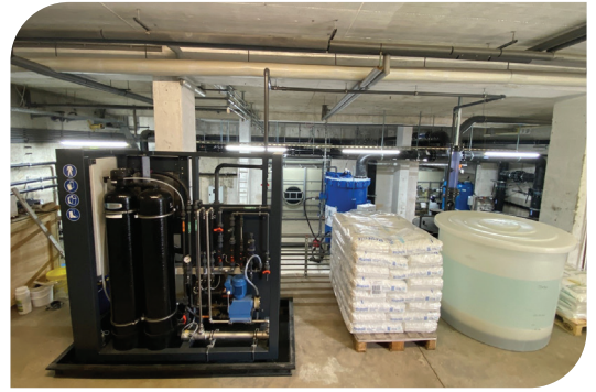
Installierte OSEC B-Pak-Anlage
