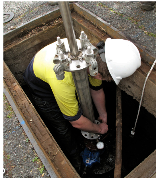
Göteborg halusi välttää kalliit ja pääomaa sitovat vaihtotyöt keräämällä käyttökelpoista dataa putkiston kunnosta Sahara-alustan avulla.
