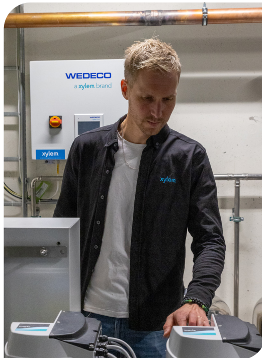
Mattias Nordblom på Xylem, med Lowara GHV med Hydrovar i förgrunden samt styrskapet för Wedecos UV-rening i bakgrunden.
