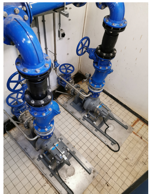
Een tweetal Flygt Concertors in een droge opstelling van het rioolgemaal aan de Telderslaan in Delft.
