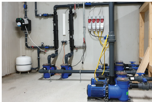
Pumpanlage 1 im Testbetrieb kurz nach Fertigstellung
