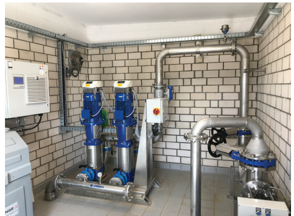
Lowara Druckerhöhungsanlage mit automatischem Hydrovar Frequenzumformer
