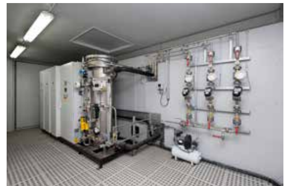
WEDECO SMOevo 710 Anlage, aufgebaut in einem Xylem Container.
