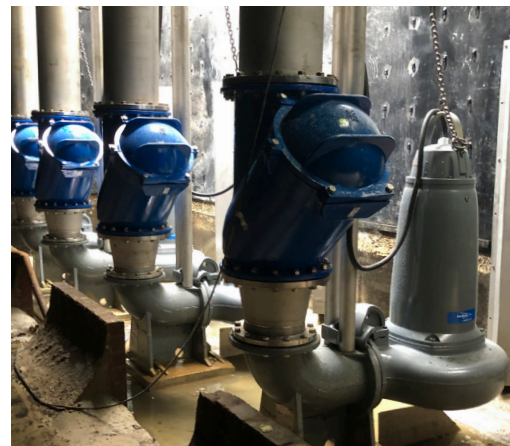
De vier nieuwe Flygt NP3301 pompen geïnstalleerd en klaar voor gebruik.
