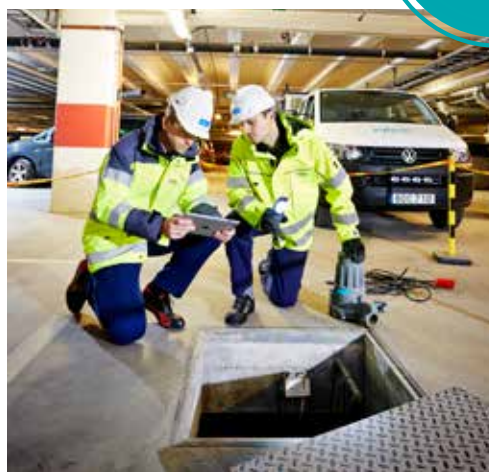
Xylem experts voeren service en onderhoud uit aan installaties
