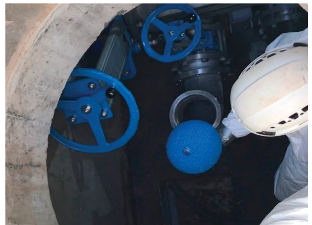
Der SmartBall kurz vor dem Einlassen in die Rohrleitung.
