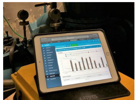
Wartung einer Pumpstation in Vlaardingen, geplant und ausgeführt mit Hilfe von Daten in XDM.
